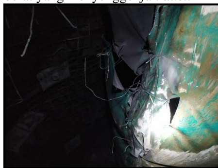
Gambar 9 Kondisi Fan Duct Yang Robek
